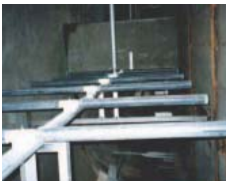
超微細気泡散気管 O 2 -マグナム施工例 (東京都水道局 新河岸処理場)
